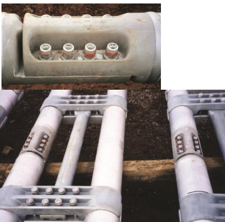
送電線鉄塔パイプジャンパー
