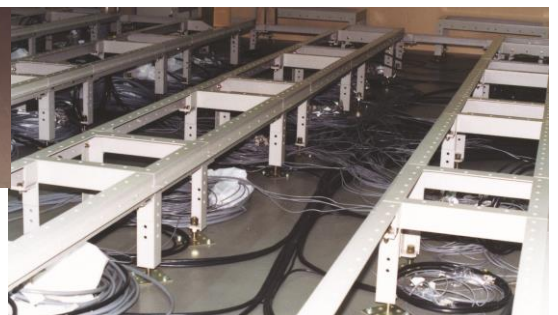
通信鉄塔デジタル架台部
